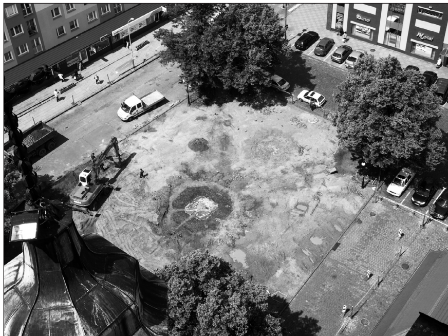
Ilustr. 5. Prace przy rewitalizacji płyty Rynku Staromiejskiego. Pośrodku odkryte pozostałości fundamentu pomnika poświęconego poległym mieszkańcom miasta i ziemi stargardzkiej w wojnie prusko-francuskiej (1870-1871), odsłoniętego 2 września 1874 r., wg stanu z 12 czerwca 2009 r. (fot. K. Kwiatkowski – Muzeum w Stargardzie)
